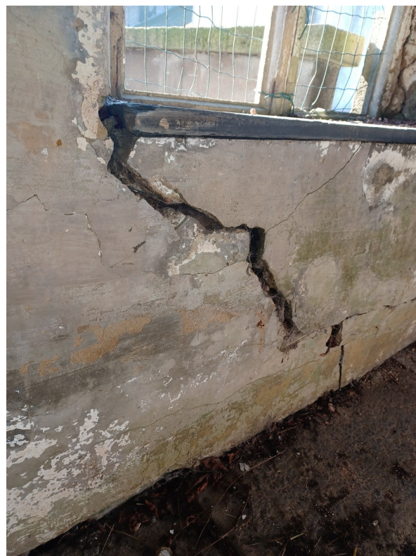
Lavoir d'Orgéo (fissure dans le mur) ↑
