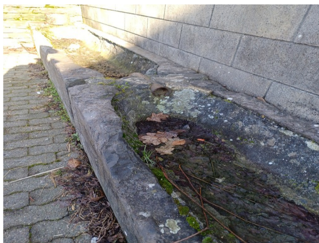
Abreuvoir (à côté du lavoir d'Orgéo) ↓
